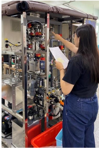
圖 十七、開關閥設備運作查核
